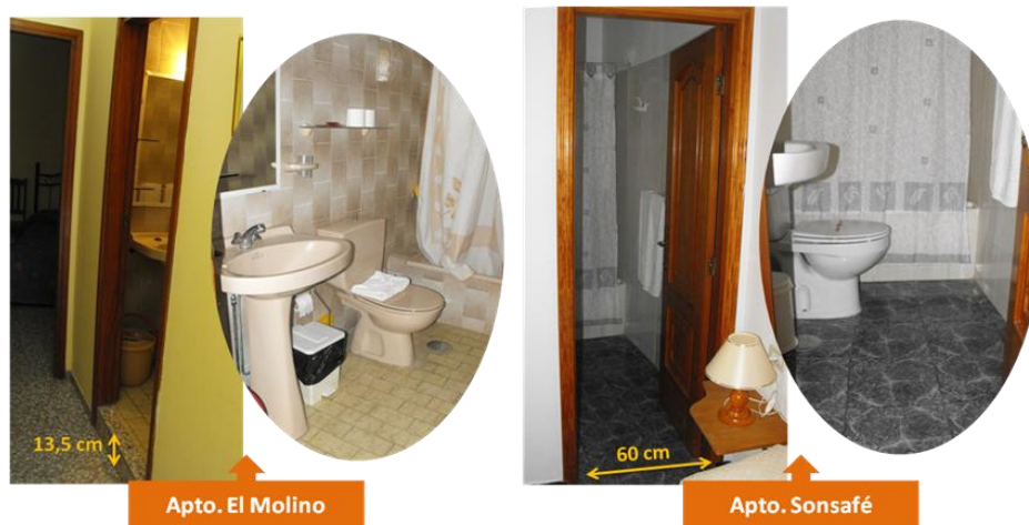
Foto 81: Detalles de los baños de los apartamentos turísticos El Molino (izquierda) y Sonsafé (derecha)
