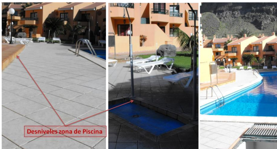
Foto 51: Área de la piscina del complejo Las 3 Palmeras y detalle de los desniveles en esta zona
